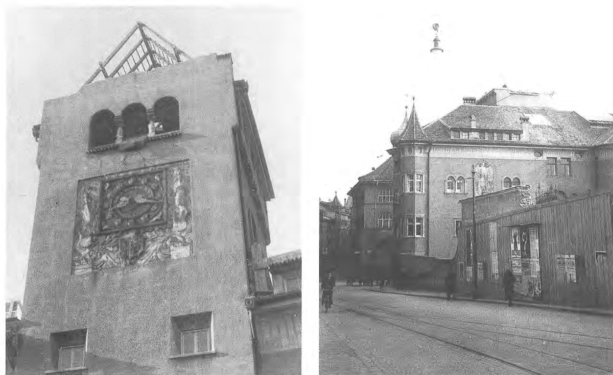
Der Abbruch des Museumsturmes — La demolizione della torre del Museo Foto: Archiv Dr. N. Mumelter — Archivio dott. N. Mumelter
