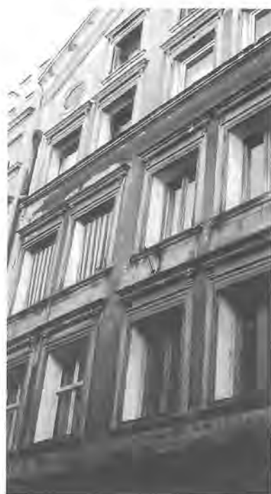
Bressanone via Portici, una facciata storica con cinque diverse tipologie di finestre.
