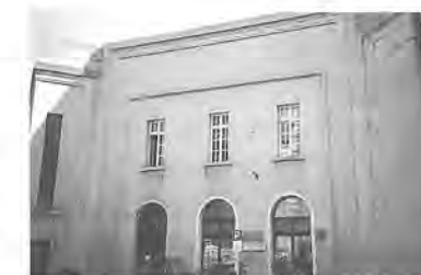
Bolzano, stazione ferroviaria: la facciata verso via Renon con le finestre "rinnovate" sia al piano terra che al primo piano.
