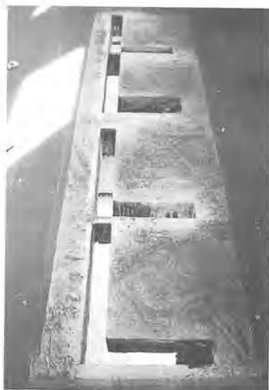
Pavimento del 1° Piano con fori per il passaggio dei cavi elettrici
